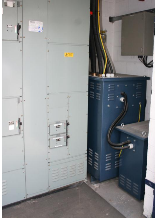
Figur 1. 10/0,4 kV station med 1000 kVA spændingssænkende udstyr (de to blå bokse)
